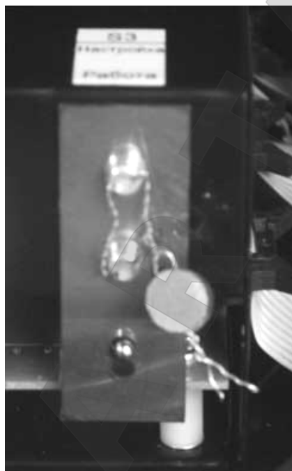
Рис.3. Пломбировка тумблера «Настройка/Работа» блока управления
